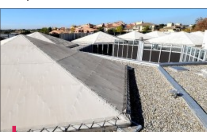
L'étanchéité du toit, à traiter en priorité.
